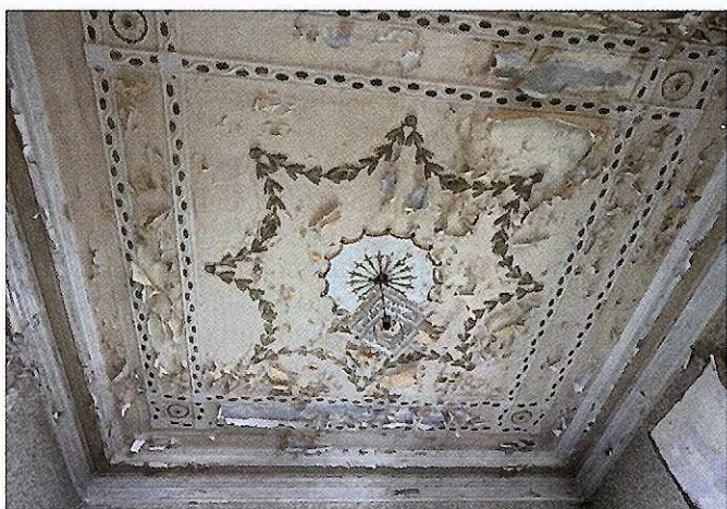
Потолок до ремонта
